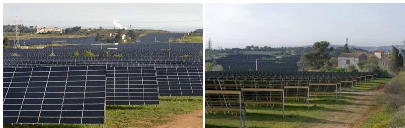
Photo 35 : Illustrations montrant le développement de la végétation sous les panneaux photovoltaïques
